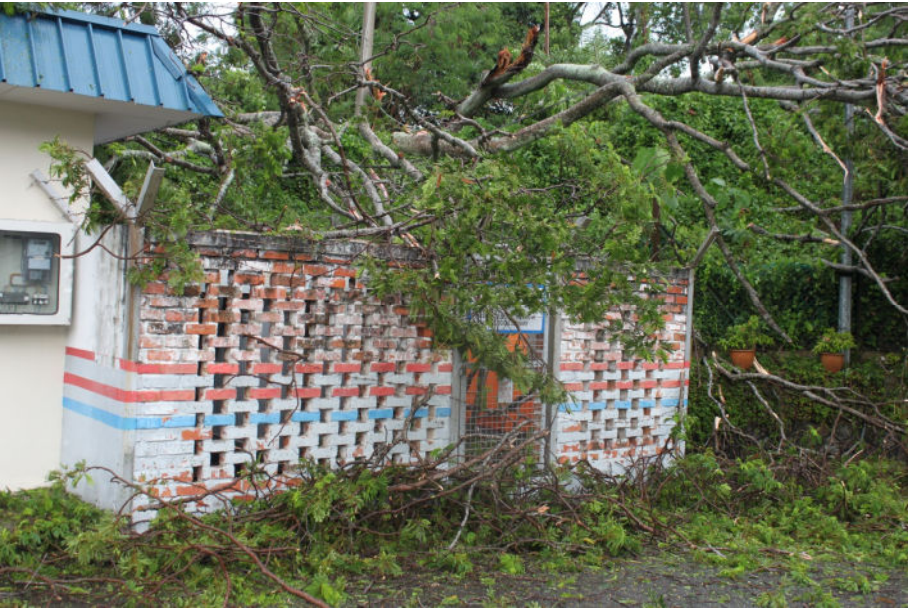
Im März stürzte nach einem Sturm ein Baum auf die Elektrizitätsanlage des STS.
