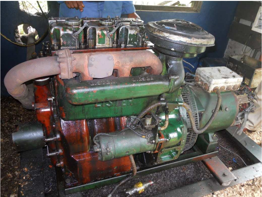
Generator mit Dieselmotor
