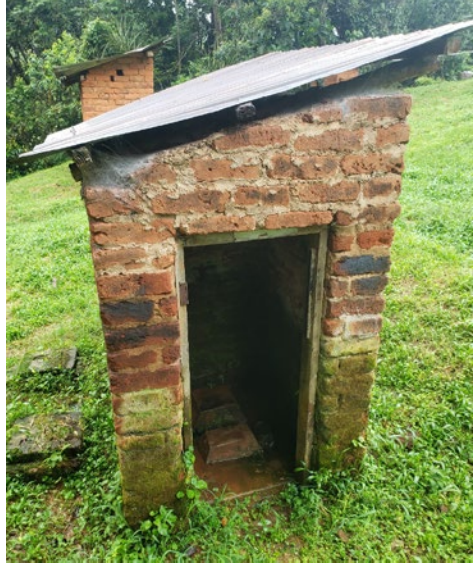
Die vorher genutzte Toilette – ohne Tür oder Vorhang.
